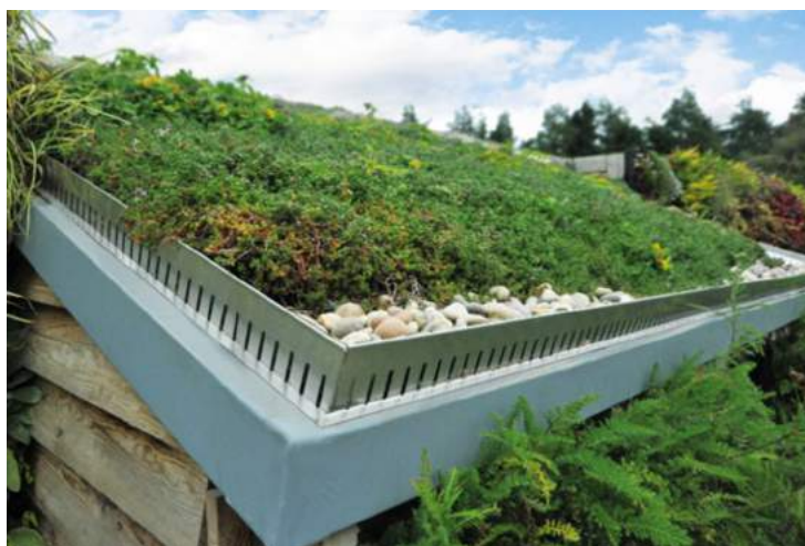
Figura 2.18- Drenagem exterior à zona verde (W15)
